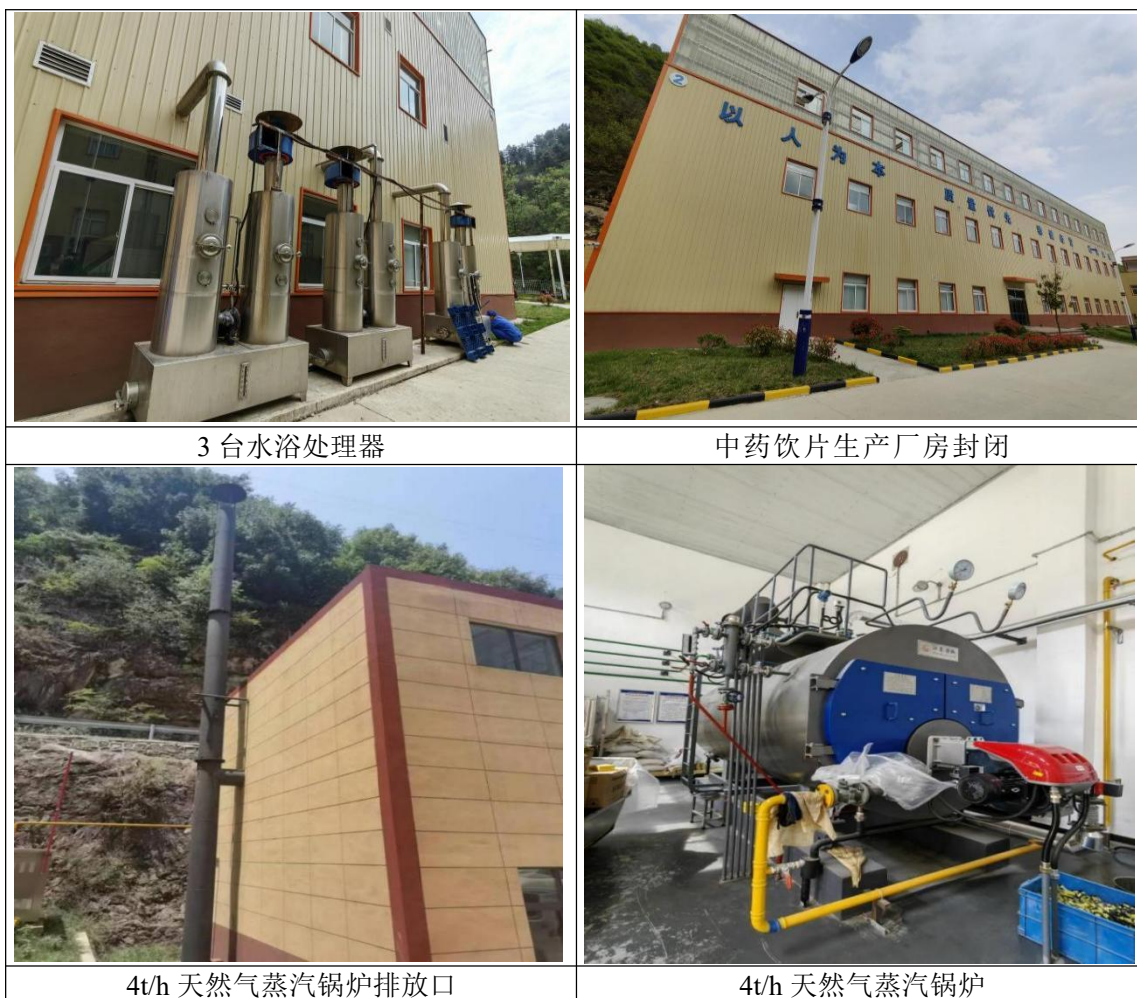
图 4.1-3 废气处理措施
